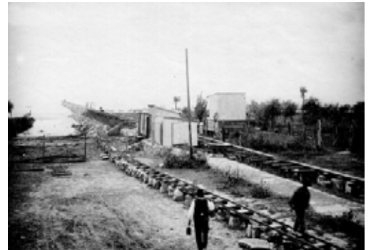
12 de Abril de 1922 - Segunda seccion de vias Decauville montadas, a mayor altura a medida que crece la escollera.
